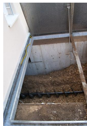
Befüllgasse mit Förderschnecke
