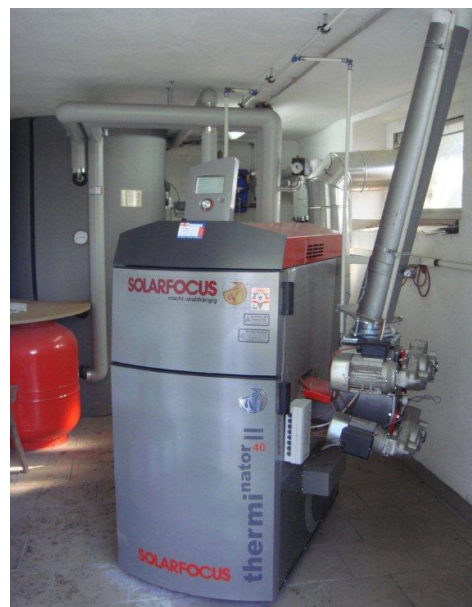
Kesselanlage mit Fallrohr
